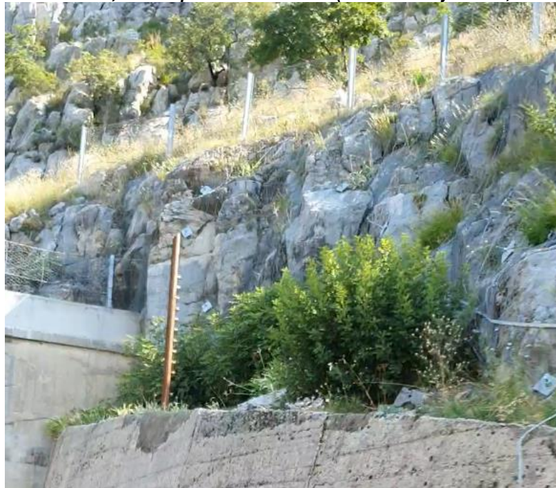
NEPROMIJENJENO STANJE; sanaciona mjera br.2 (barijera, SN ankeri, čelična mreža velike čvrstoće)
