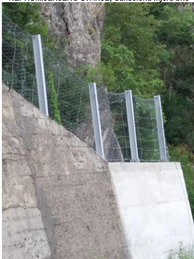
NEPROMIJENJENO STANJE; Sanaciona mjera br. 10
