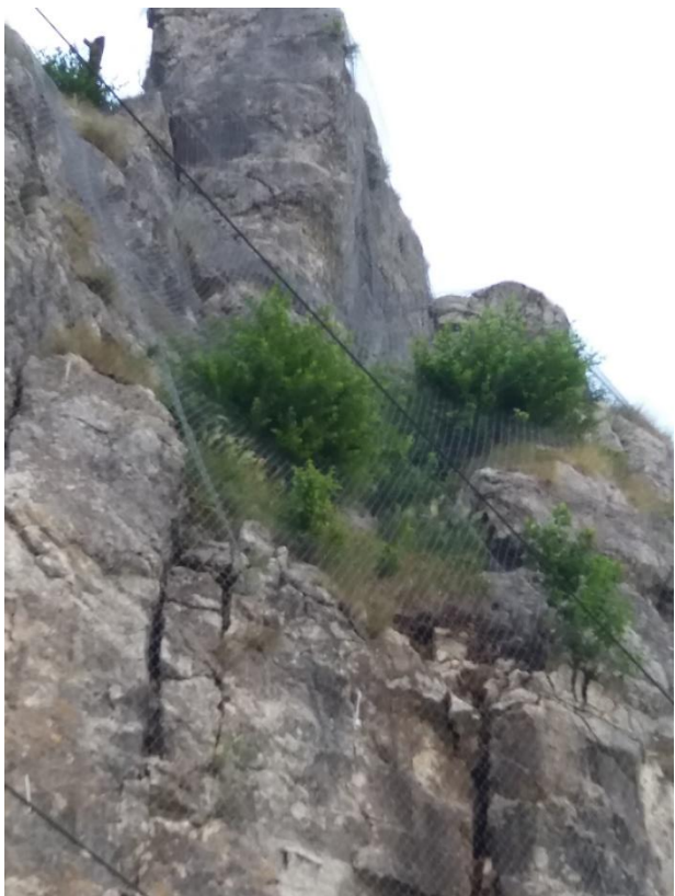
NEPROMIJENJENO STANJE; Sanaciona mjera br. 13
