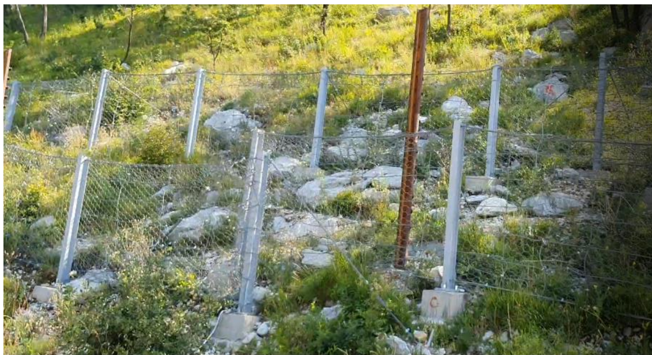
NEPROMIJENJENO STANJE; Sanaciona mjera br.4 (barijera od čelične mreže velike čvrstoće u dva reda po vrhu kosine)
