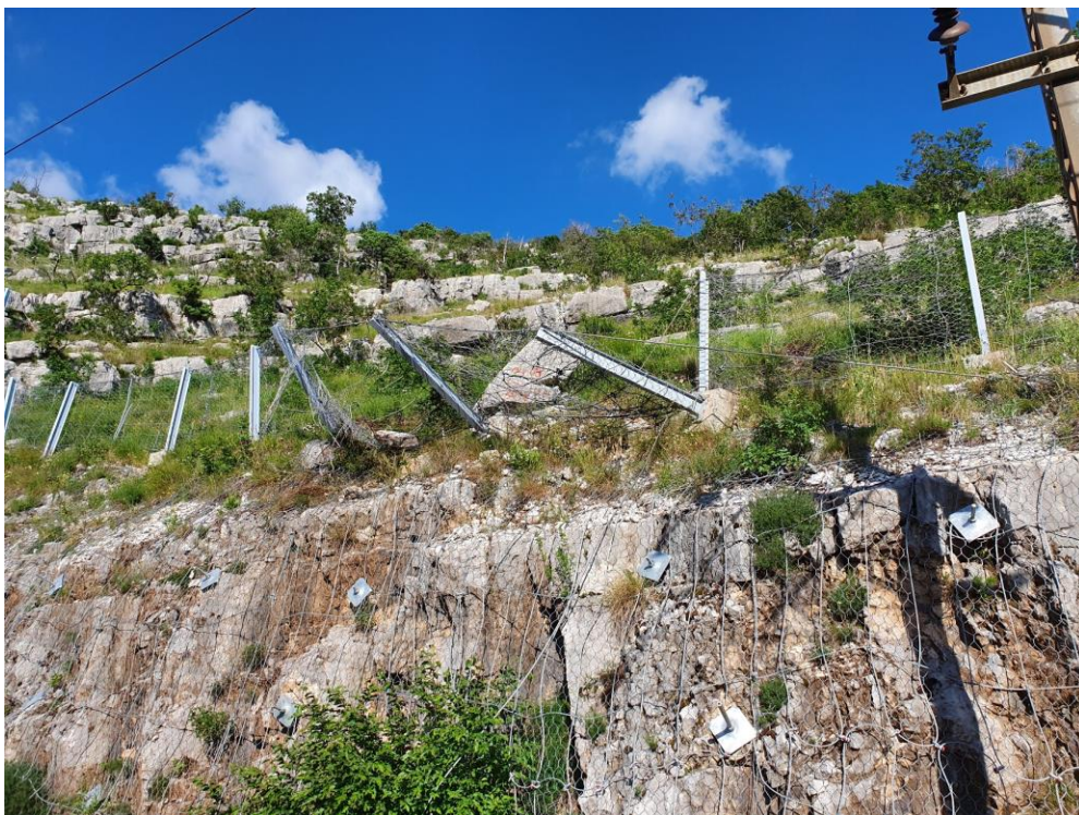
Foto.br.1 i 2.- Oštećenje barijere (11.06.2020) u dijelu kosine gdje je izvedena sanaciona mjera br.2 (barijera, čelična mreža visoke čvrstoće, IBO i SN ankeri)
