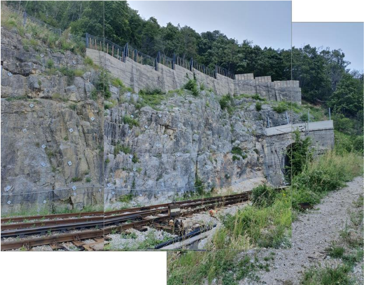
NEPROMIJENJENO STANJE; Sanaciona mjera br. 18 i br.19
