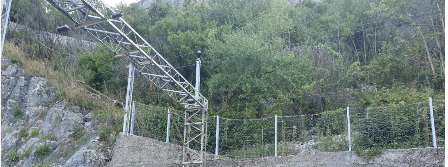
NEPROMIJENJENO STANJE; sanaciona mjera br. 7
