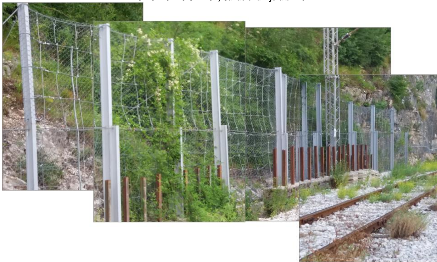
NEPROMIJENJENO STANJE; Sanaciona mjera br. 17
