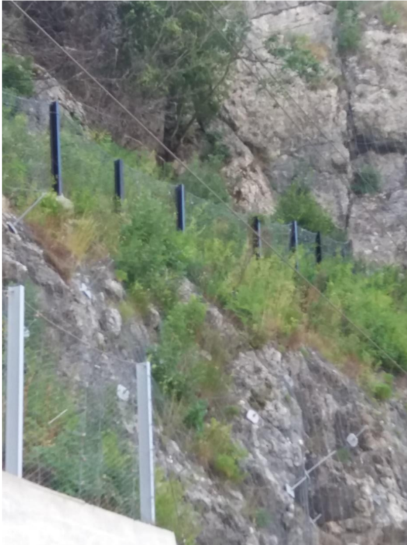
NEPROMIJENJENO STANJE; sanaciona mjera br. 8
